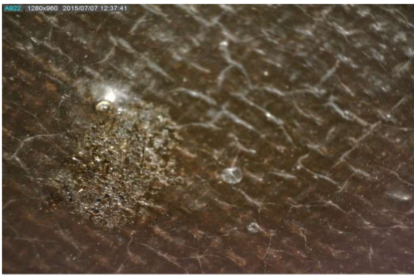
Schimmels en witte waas zichtbaar
